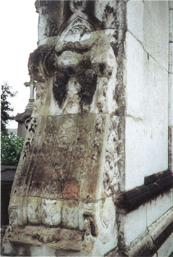
▲ Aantasting door algen en korstmossen (foto Jacques Vereecke)
