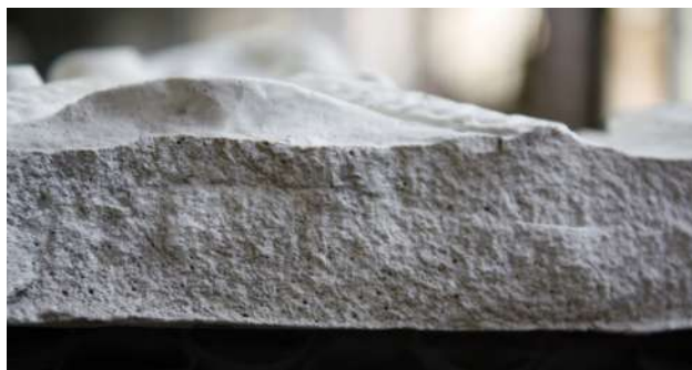
Ligne de démarcation entre les deux couches de plâtre (© Laura Porcu)
